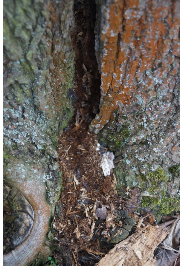
Abb. 4: Mulmaustritt aus Spalt
